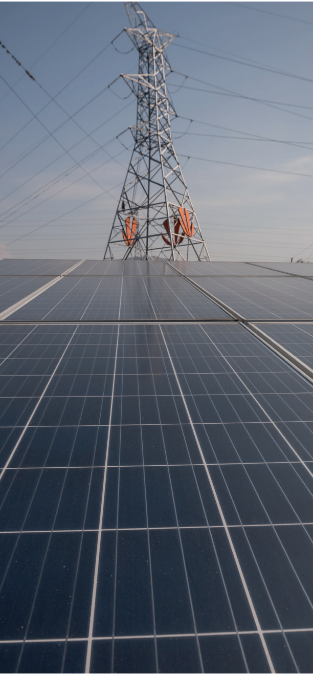
Celsia Solar Yumbo
