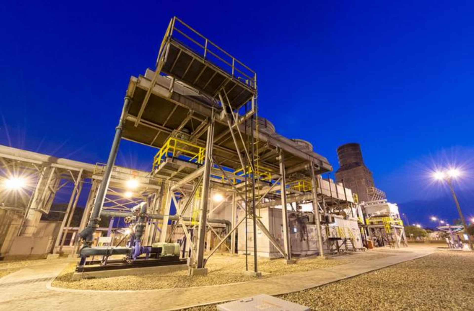
Merielectrica (termo)- Santander
