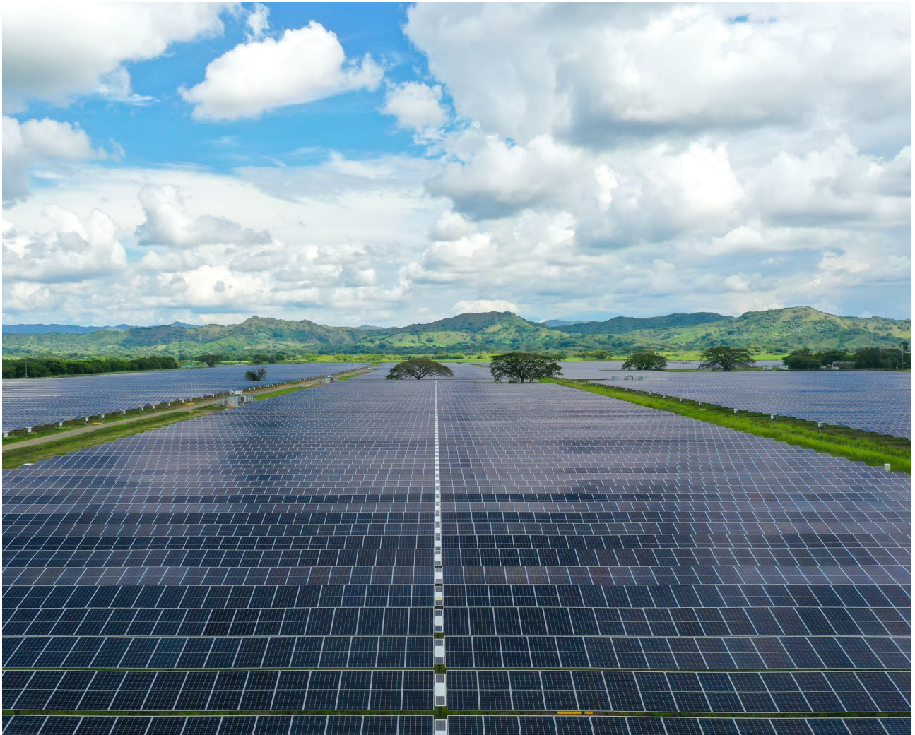
Celsia Solar La Victoria Valle del Cauca
