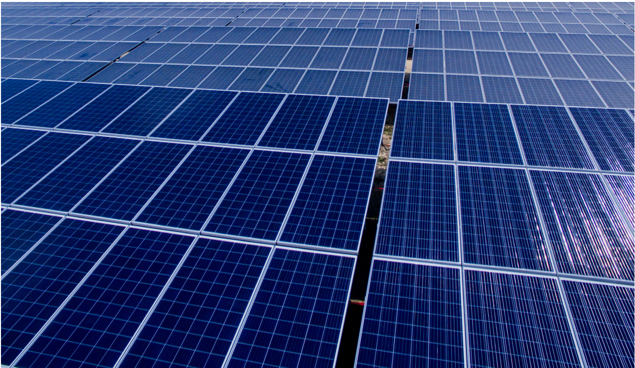
Celsia Solar Santa Rosa de Lima Bolívar
