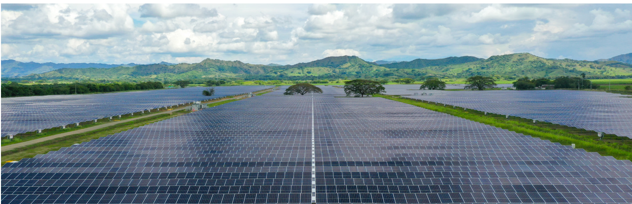
Celsia Solar Victoria 1 Valle del Cauca
