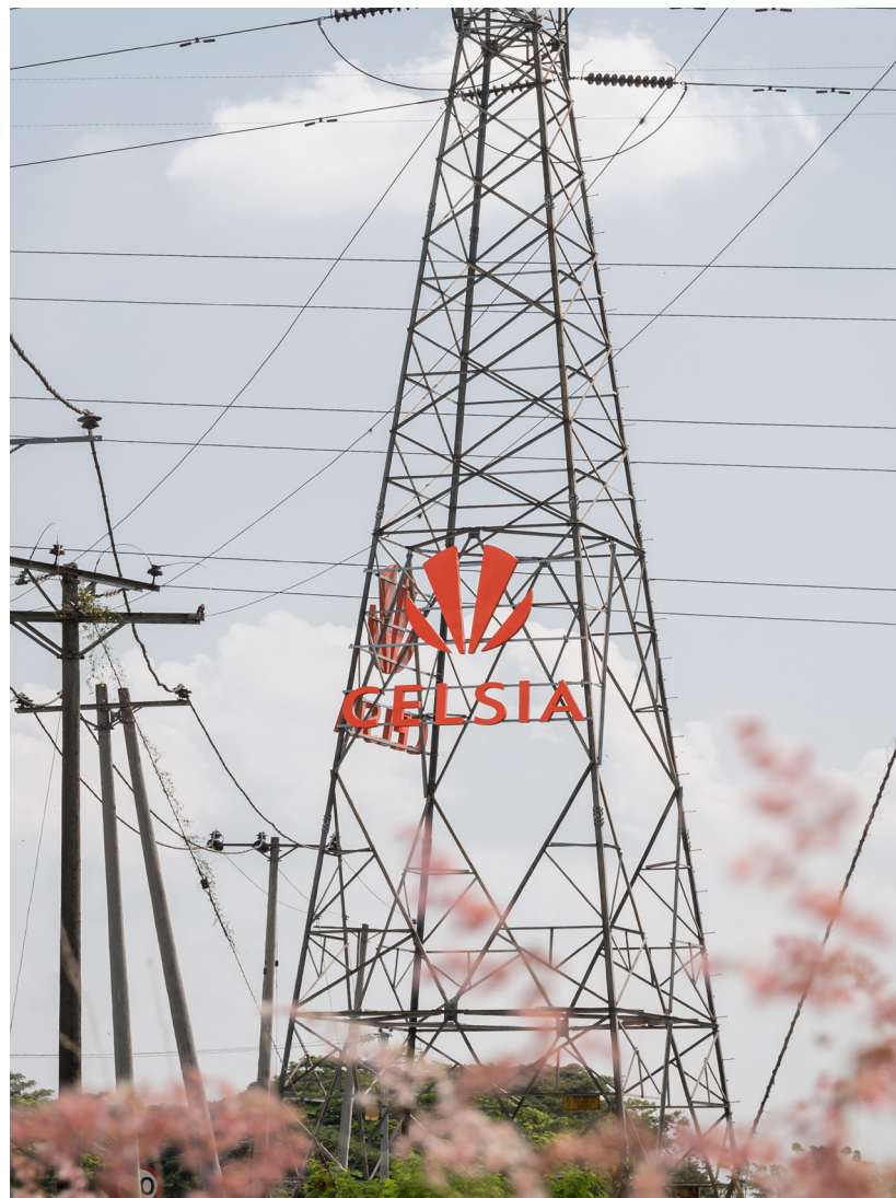
Torre de energía Celsia Valle del Cauca
