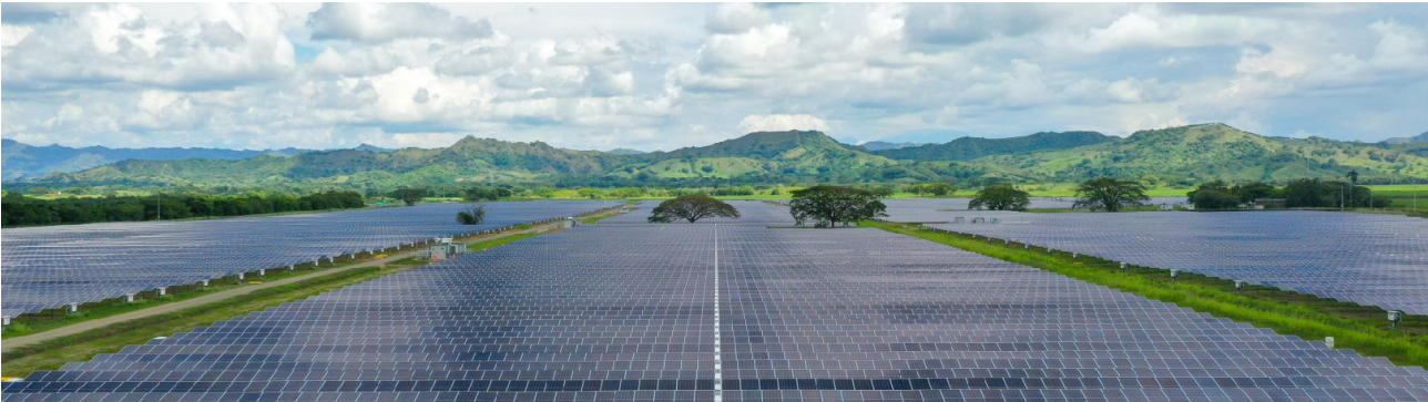
Celsia Solar La Victoria Valle del Cauca
