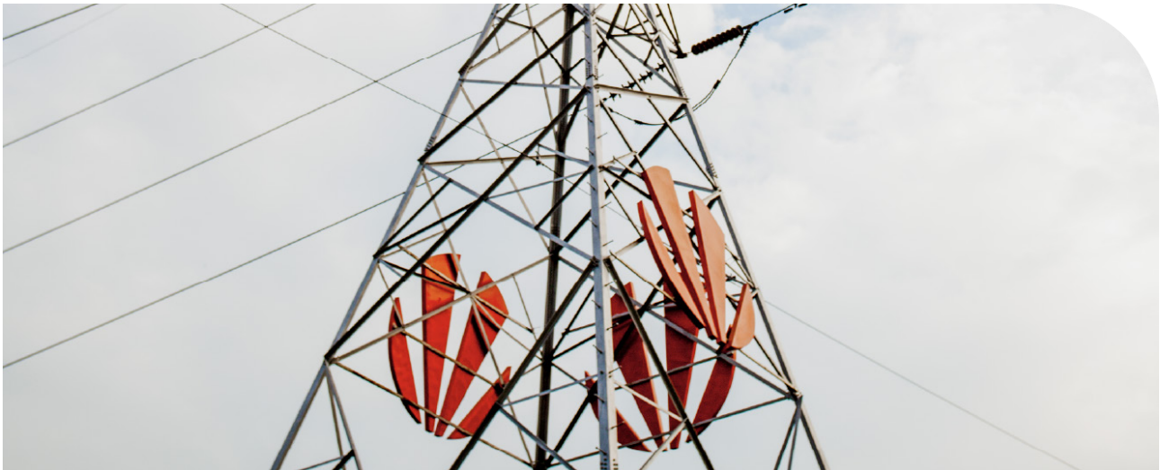
Torre eléctrica Celsia, Valle del Cauca
