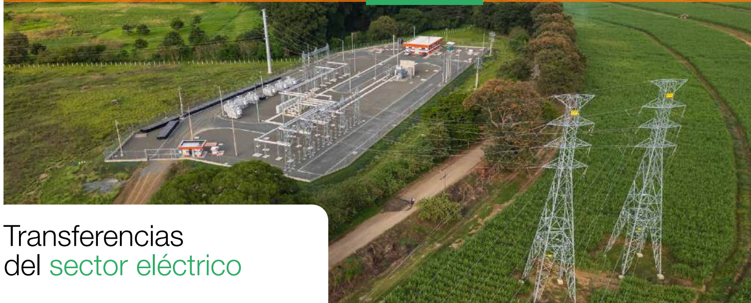
Subestación Estambul, Valle del Cauca.
