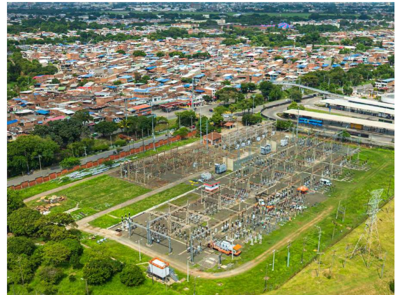
Subestación Juanchito 115 kV, Cali, Valle del Cauca.
