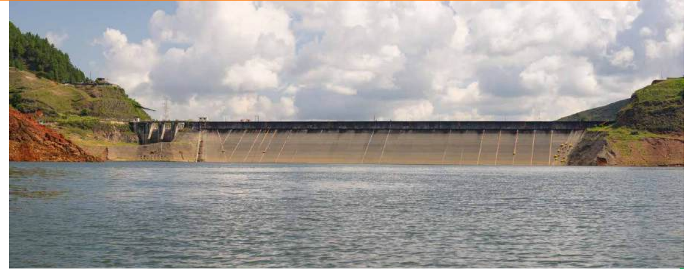
Central hidroeléctrica Salvajía, Cauca.
