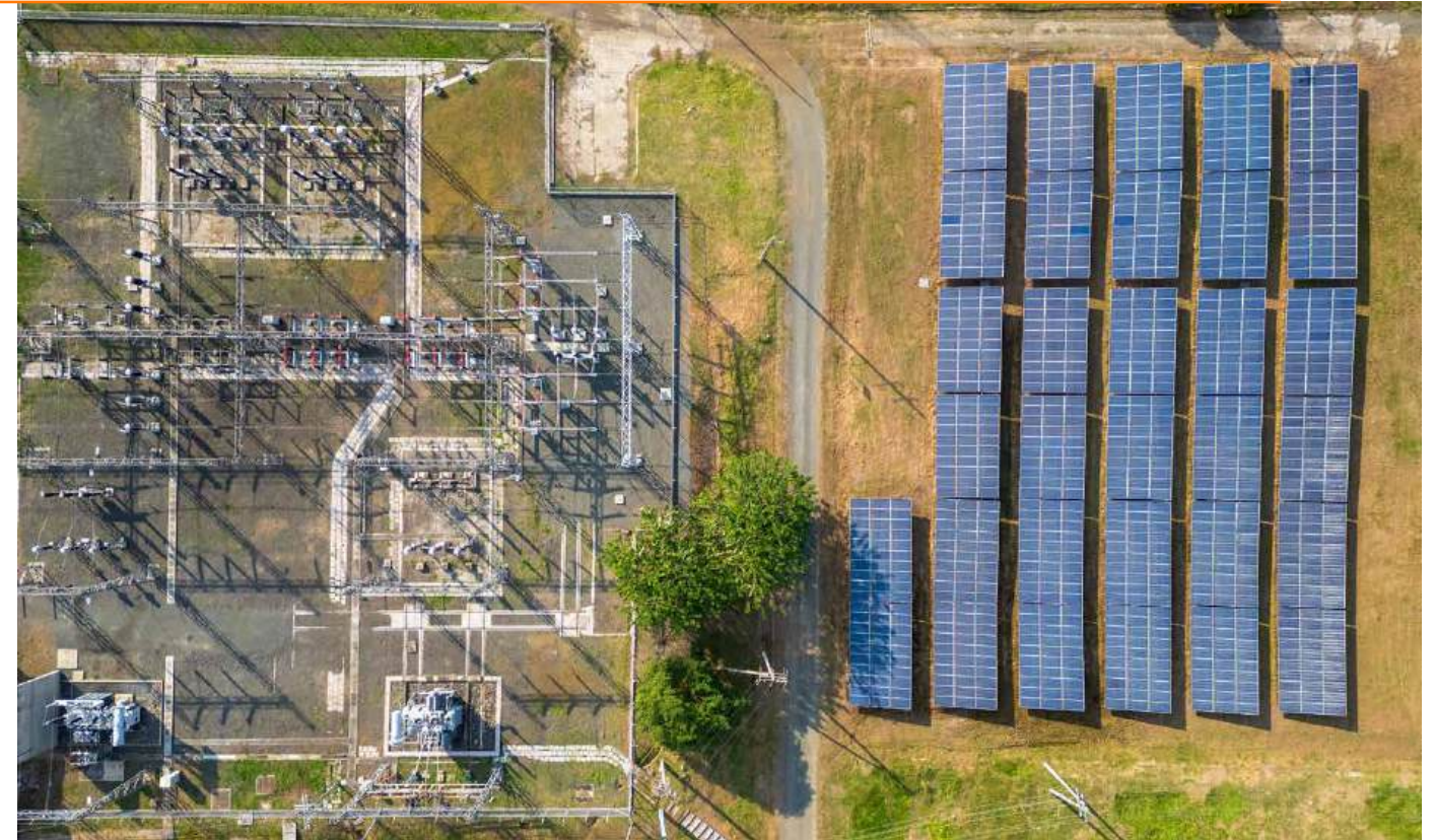
Celsia Yumbo Solar Farm, Valle del Cauca
